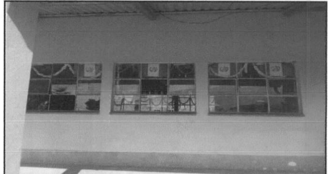
Foto 2: Sustrucción de vidrios
