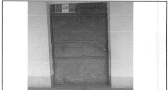
Foto 4: Sustrucción de puertas de aulas
